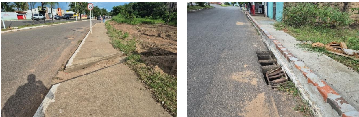
Figura 9. Imagens de soluções pontuais de drenagem
